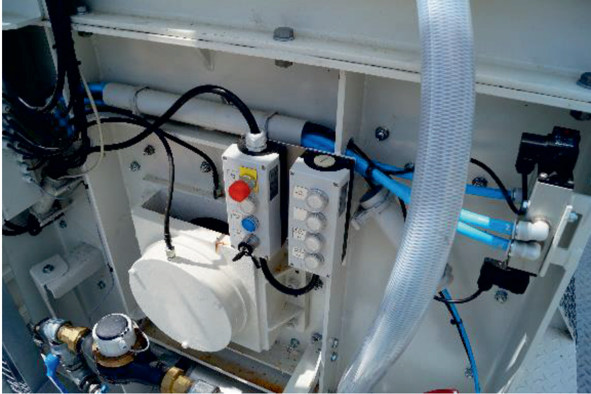
Lokale bediening van de menger. Waterdosering via flowmeter.
