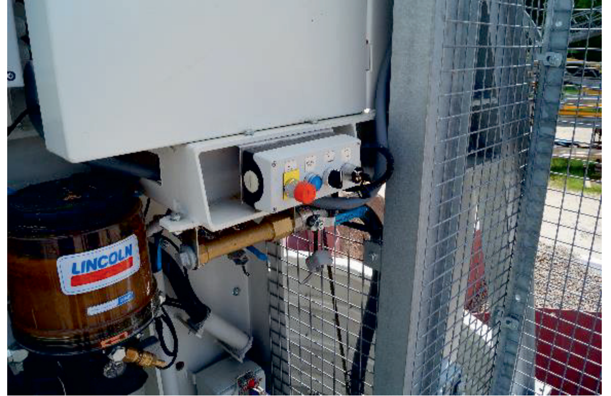
Centrale vetsmering voor de menger. Lokale bediening van de lierinstallatie.
